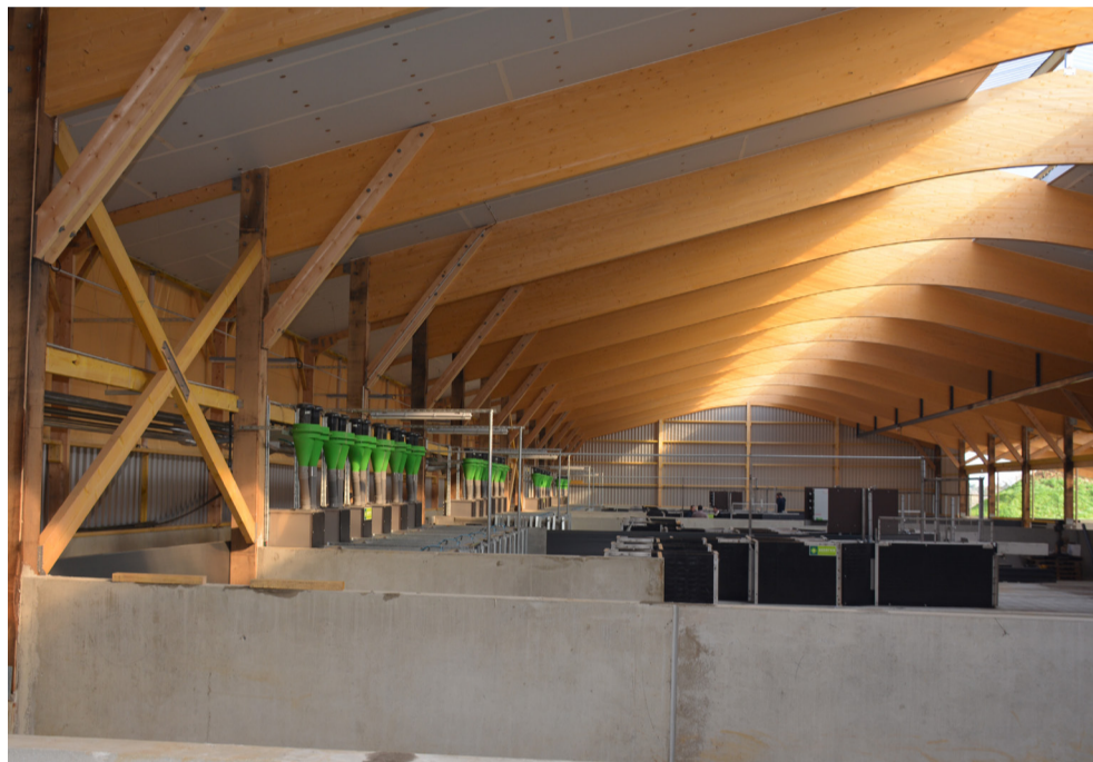
Le hangar de 34 mètres de longueur, sur 20 m de largeur, sans les courettes extérieures. L'éleveur a réalisé une partie de la maçonnerie (Maison Bleue). La charpente a été réalisée par Berthelot Charpentes et Eurosom a installé les rideaux amovibles sur les deux façades (pilotage manuel).
